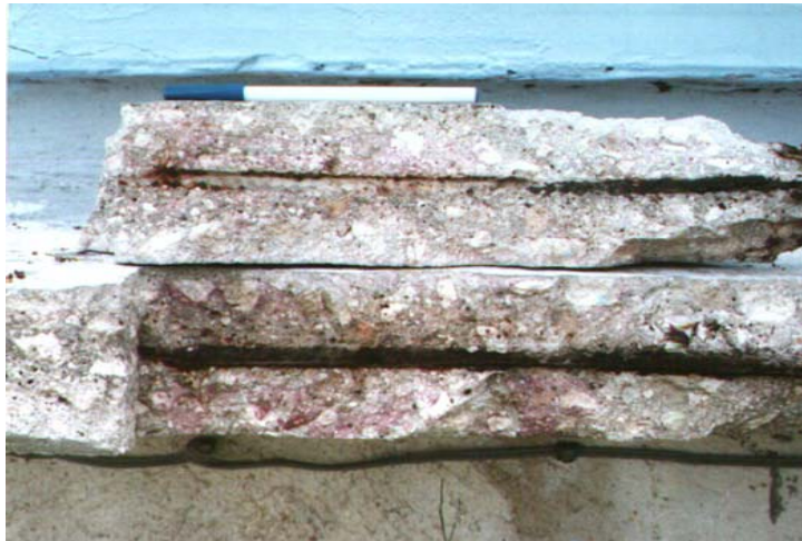
Frente de carbonatación y corrosión generalizada del refuerzo
